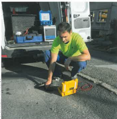
Na místech vytipovaných metodou satelitní detekce se přesné místo poruchy hledá standardními technikami. Oproti běžné praxi je podle zkušeností z pilotního projektu potřeba věnovat hledání více času a větší trpělivost, protože se vesměs jedná o malé, špatně lokalizovatelné úniky
